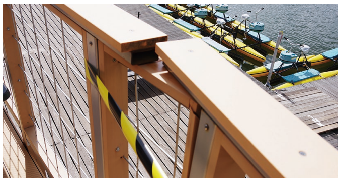
落雪で破損した女神湖センターデッキ
