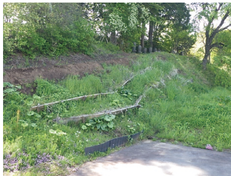
災害復旧箇所 (茂田井)
