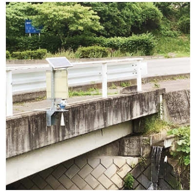
番屋川の藤沢橋に設置、危機管理型水位計
