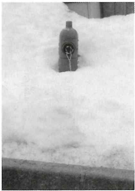
埋もれている消火栓
