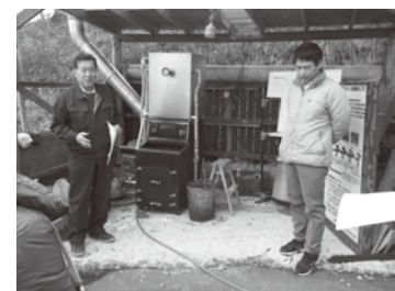
木質バイオマスロケットボイラー
