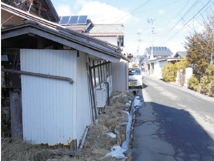
町道に面していて倒壊で事故が起きるおそれがある
