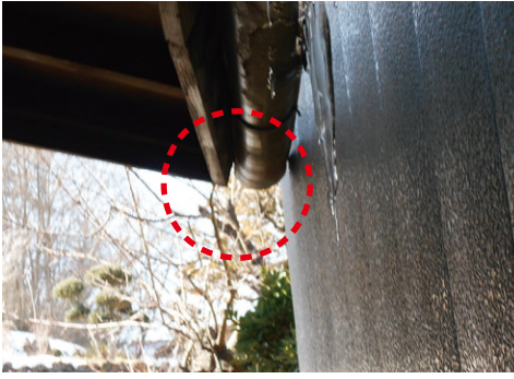
隣家のガレージの壁に接触している
