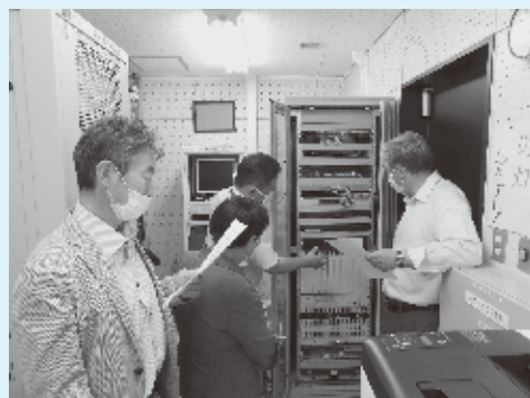
立科町役場庁舎放送室
