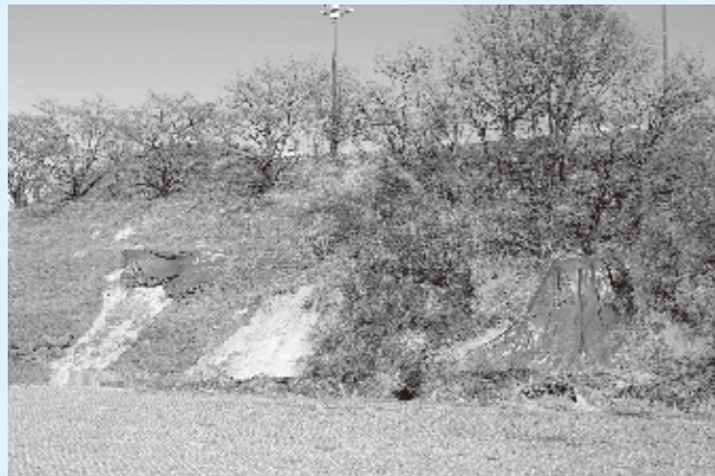
権現山運動公園西側崩落
