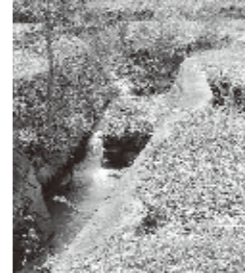
大雨で崩れた護岸の牛鹿川
