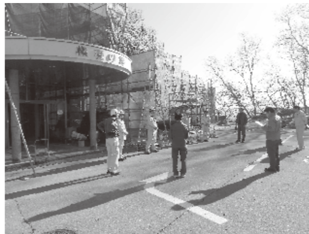
改修工事中の「権現の湯」 思いのほか鉄骨の腐食が進んでいる
