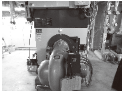
更新されたボイラー
