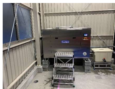
消滅型生ごみ処理機（女神湖商店街駐車場）
