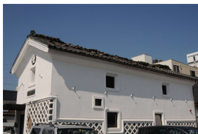
長野県中部の地震（H23.6.30）
