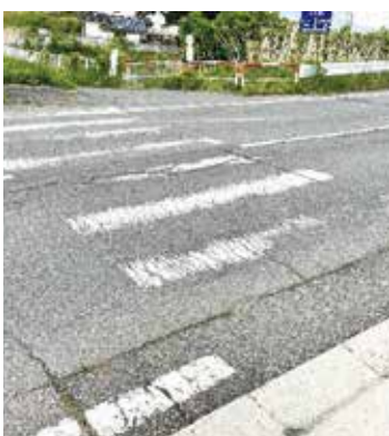
消えかかった横断歩道
