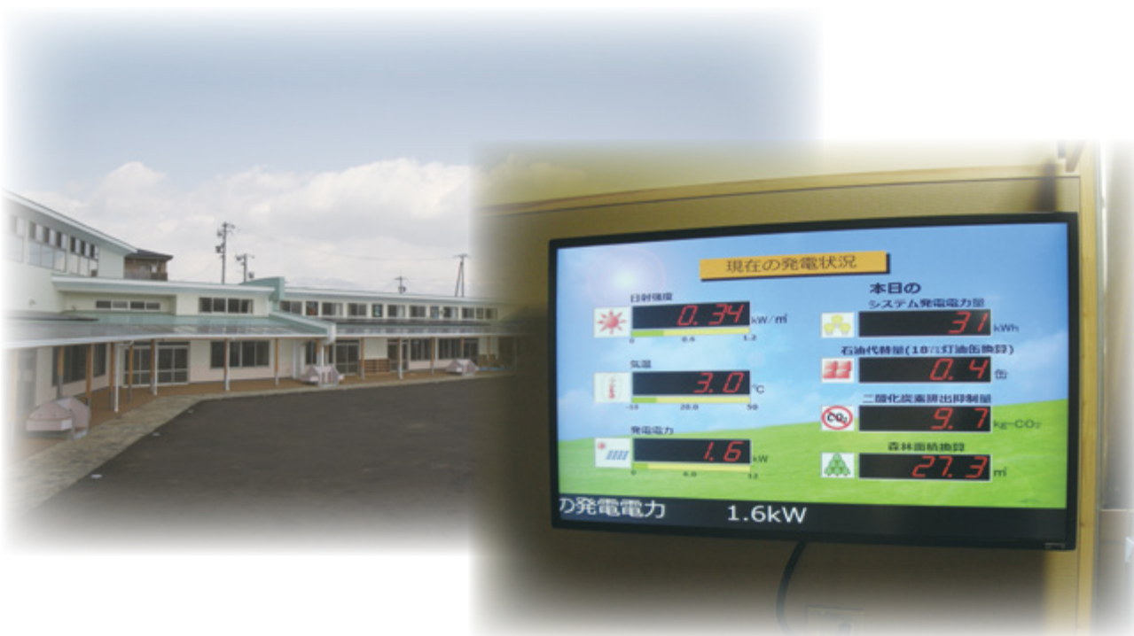
たてしな保育園 太陽光発電システム
