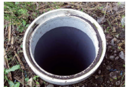
× (蓋が破損し開いている状態)
