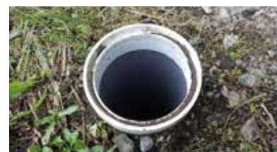
× (蓋が破損し開いている状態)
