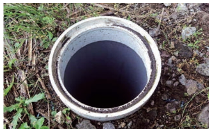
× (蓋が破損し開いている状態)
