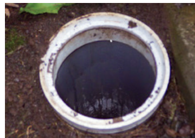
× (蓋が開いている状態)
