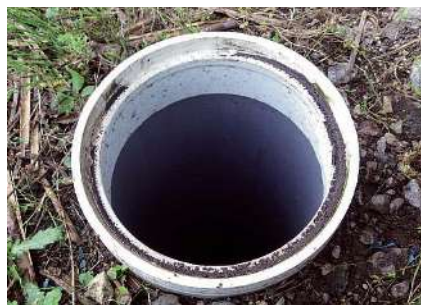
× (蓋が破損し開いている状態)
