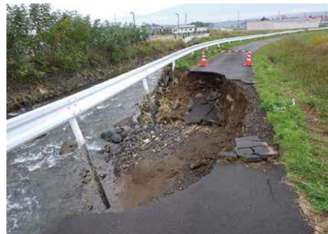
路肩崩落（町道堀越峯二号線）
