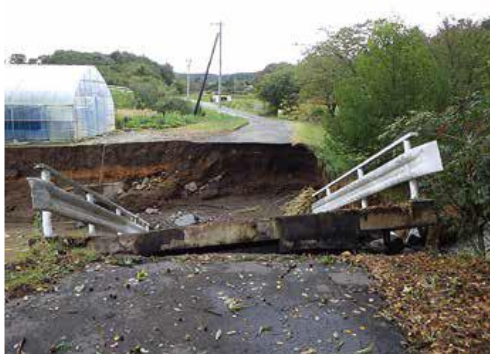
梨の木橋の崩落（町道梨の木線）
