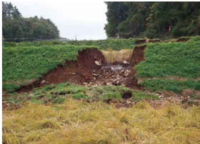
水田土手崩落(蟹窪)
