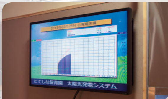
太陽光発電システム
